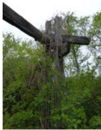
Abbildung 18 | Stark geschädigte Pergola am Rodelhügel (Brigitte Gehrke, 2013)
