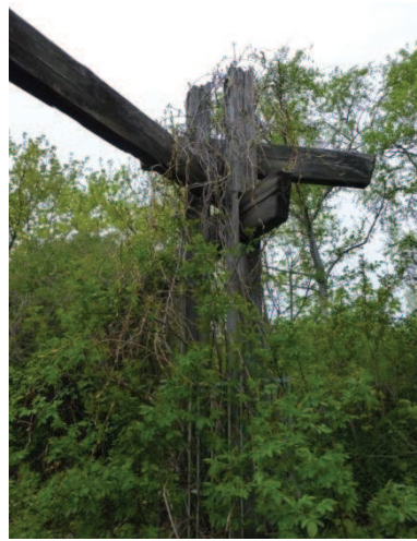
Abbildung 19 | Stark geschädigte Pergola am Rodelhügel (Brigitte Gehrke, 2013)
